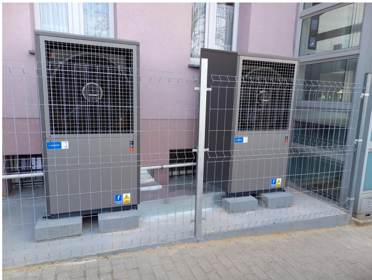
Zdjęcie 1. Pompa ciepła zamontowana przy POZ w Zawidowie
