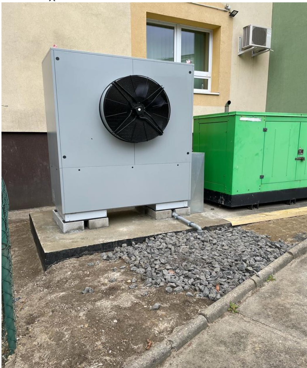
Zdjęcie 2. Pompa ciepła zamontowana przy Ośrodku Rehabilitacji w Zgorzelcu.
